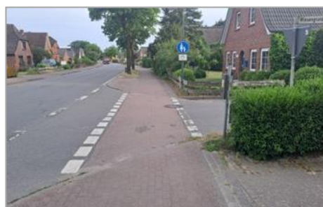
Abbildung 28: Einmündung Wiesengrund: abgängige Blockmarkierung
