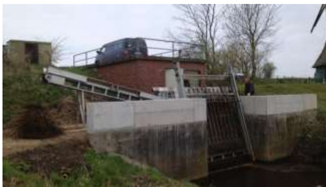
Pumpe mit Rechenanlage am Stördeich
